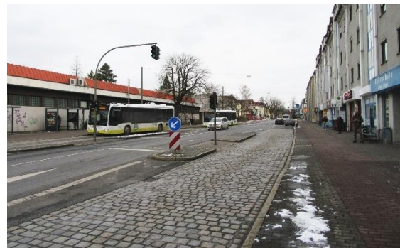
Foto: Haltestelle Berufsschulzentrum mit Großpflaster, bislang keine Sanierung
